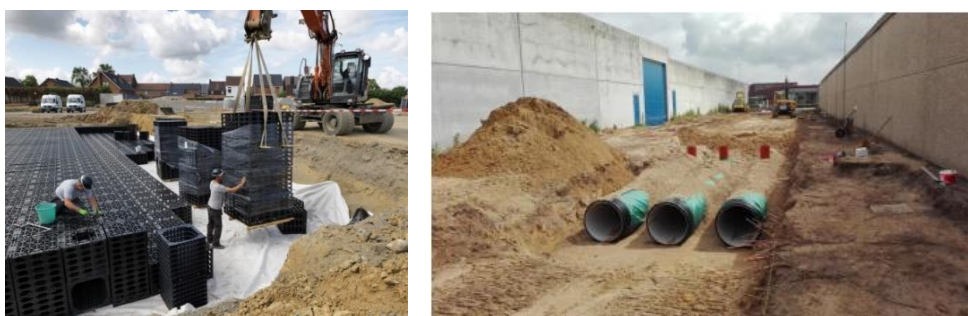
Figuur 7-9 : Voorbeelden van ondergrondse infiltratie met kratten (links; bron: Pidpa) en infiltratieleidingen (rechts; bron: Vlario, 2017)
