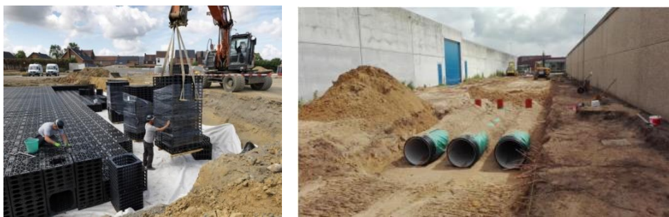
Figuur_Bijlage D-8: Voorbeelden van ondergrondse infiltratie met kratten (links; bron: Pidpa) en infiltratieleidingen (rechts; bron: Vlario, 2017)
