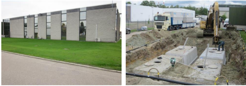
Figuur_Bijlage D-11: Voorbeelden van het bovengronds (links; bron: Vlario, 2014) of ondergronds bufferen (rechts; bron: Vlario, 2014)
