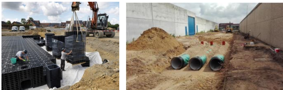
Figuur 7-10 : Voorbeelden van ondergrondse infiltratie met kratten (links; bron: Pidpa) en infiltratieleidingen (rechts; bron: Vlario, 2017))
