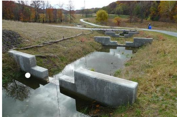
Figuur 7-4 : Voorbeelden van baangrachten gecompartmenteerd door middel van betonnen stuwen met overloopprofiel. Dergelijke stuwen zijn te verkiezen boven knijpconstructies met een opening onderaan
