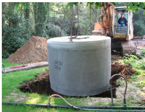
Figuur 7-29 : Het plaatsen van een hemelwaterput voor het opvangen en hergebruiken van hemelwater
