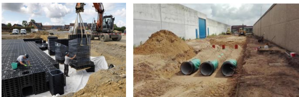
Figuur 7-9 : Voorbeelden van ondergrondse infiltratie met kratten (links: Pidpa) en infiltratieleidingen (rechts: (Vlario, 2017))
